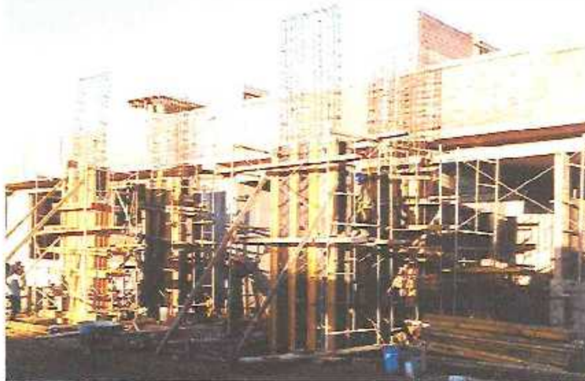
Encofrado de placas en el Ingreso Principal Cobertura 02 ubicado frente al Módulo A /
